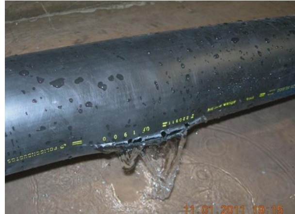
Foto 3: Tubo fallado por repetición de sobrepresión extrema, Prueba 3b.
