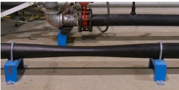
Foto 6: Deformación de la tubería RD 41 durante la tercera depresión, Prueba 4.
