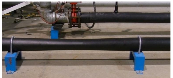
Foto 7: Deformación de la tubería RD 41 durante la cuarta depresión, Prueba 4.
