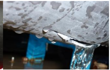
Foto 4 Falla tubo RD32.5
