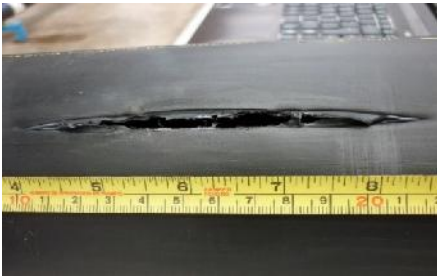
Foto 2 Falla tubo RD41
