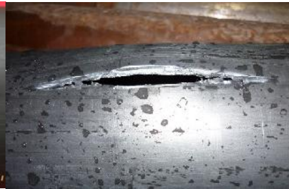
Foto 6 Falla tubo RD26
